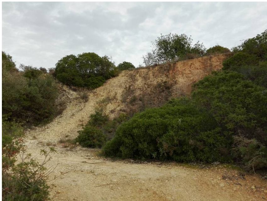
Figura 3.30. Aspeto geral de um deslizamento superficial resultante da abertura de um caminho
